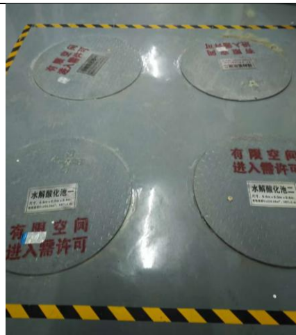
地下池体井盖
