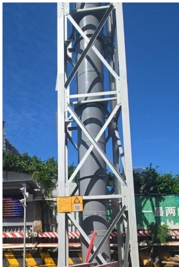
临时废气排放口
