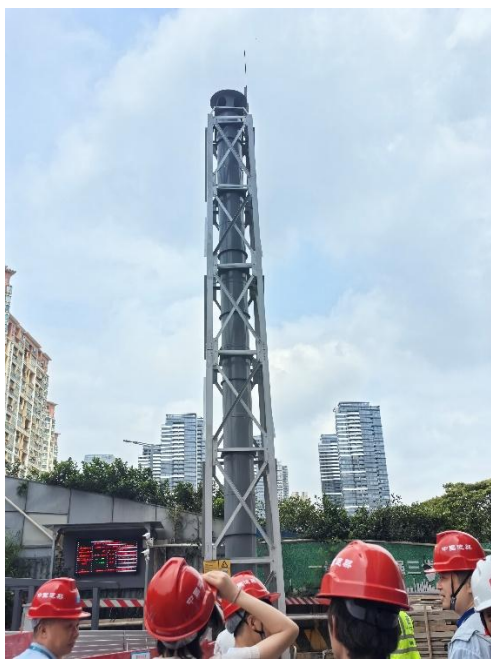
临时废气排放口 15 米
